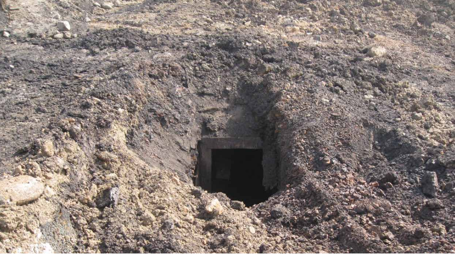
Abb. 3: Ehemalige Strecke aus dem Braunkohleabbau in der Rhön; Aufschluss während der Abraumarbeiten 2010 im Basalttagebau Bischofsheim (Foto: Papelitzky)
